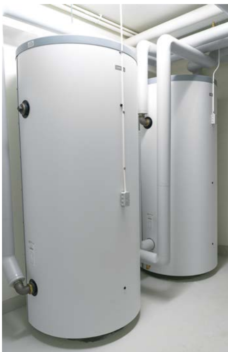
Göran Bengtsson har styrt projektet med både hjärta och järnhand. Förutom solcellerna som driver värmepumparna återvinner man nu värmen i frånluften och tillför energin till borrhålen och värmepumparna.
