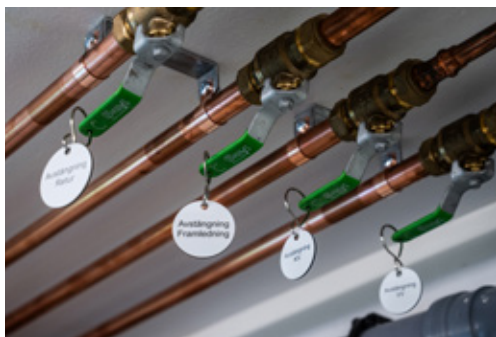
Pablo har tagit fram egna märkskyltar till avstängningsventilerna.
